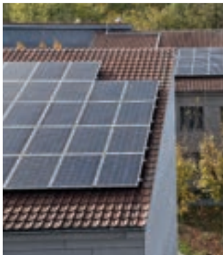
PV-Anlagen am Vogeliusweg
